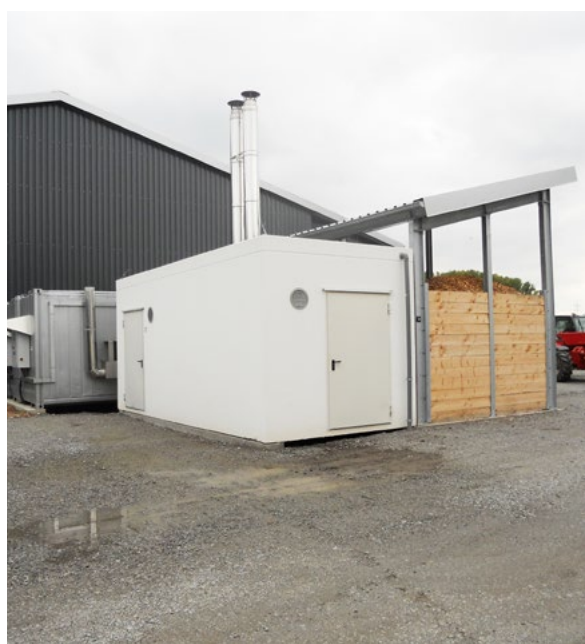
Modulo di riscaldamento a un piano 2 x 100 kW cippato, settore commerciale
